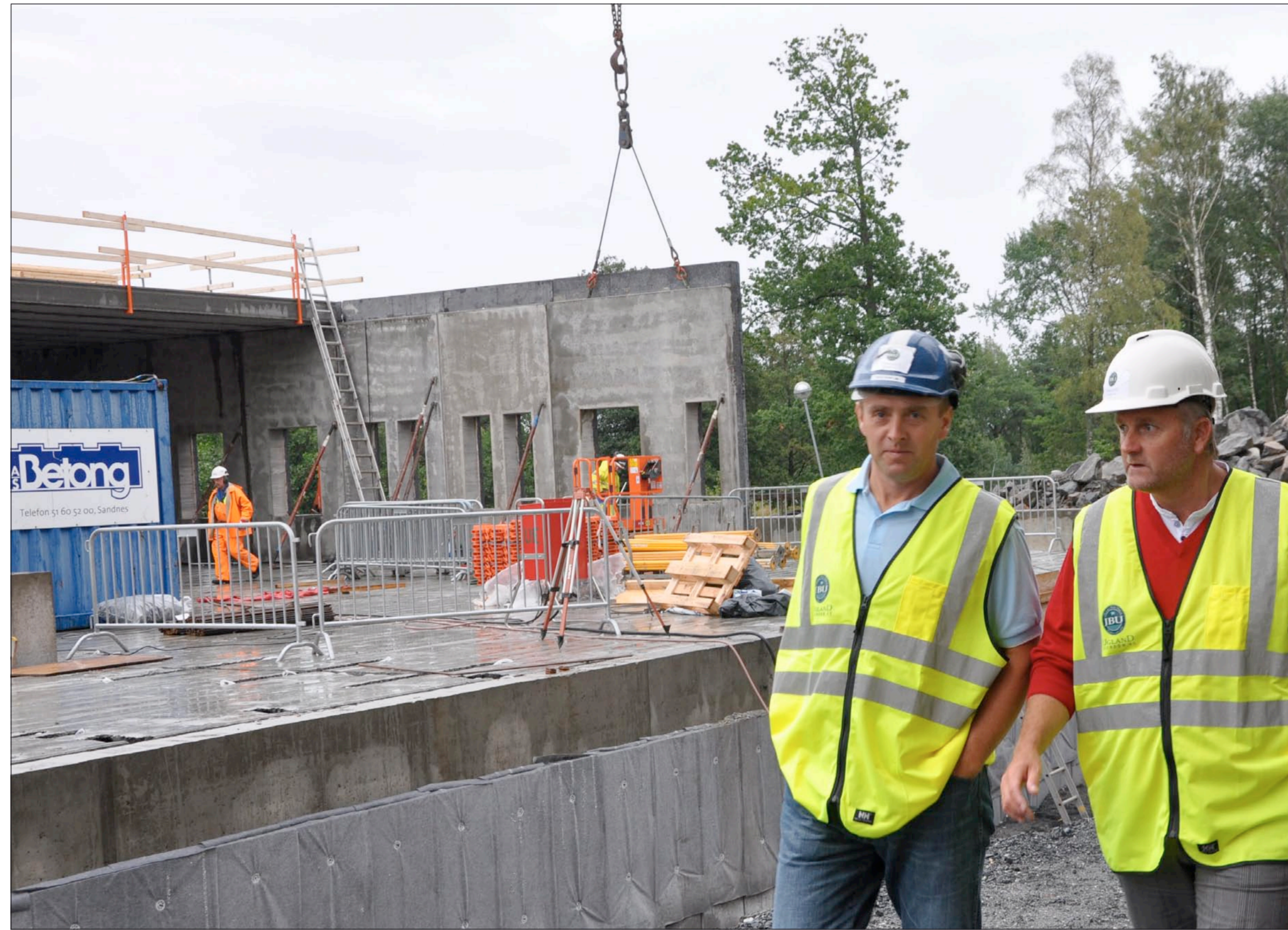
OVERSIKT. Prosjektleder Helge Nilsen i J. B. Ugland Entreprenør AS og adm. dir. Bjørn Vedal i J. B. Ugland Eiendom AS var onsdag ute på anleggsplassen og kikket over arbeidene. De ser at alt er i rute foran vinteren, da man håper at «rammen» rundt storbygget er tett. Så følger flere måneder med innredning av totalt fire etasjer fordelt på tre byggseksjoner og 9.800 kvadratmeter med innearealer.
